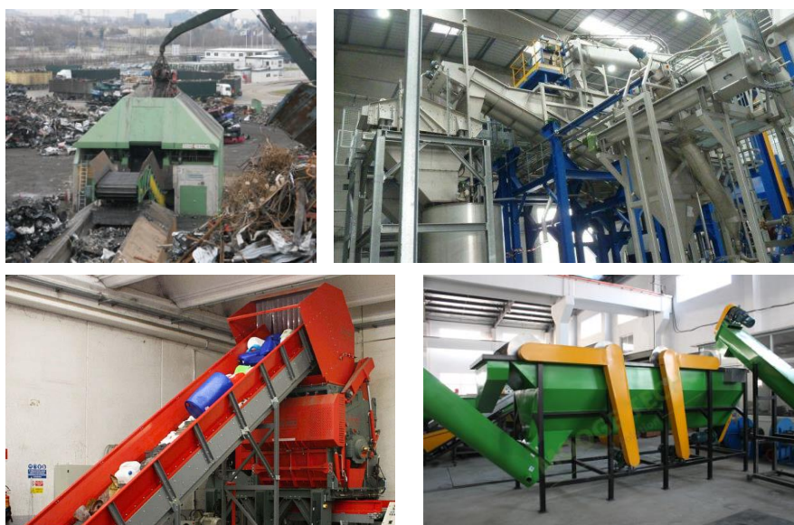
Figure 44 : ressources de broyage et tri d'un broyeur VHU (haut) et d'un broyeur-flotteur (bas)
