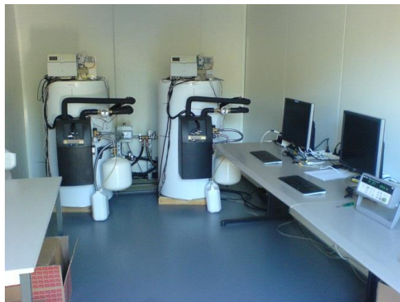
2-Les 2 chauffe-eau à tester
