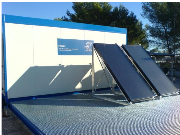
1-Module et capteurs solaires
