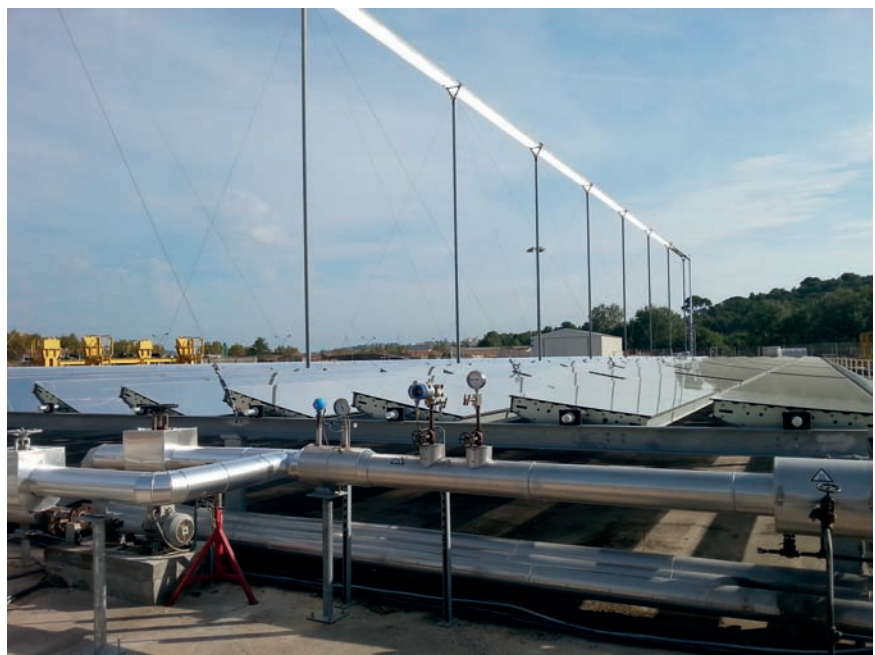
Figure 1. Prototype d'une installation de conversion thermique du rayonnement solaire sur le site de la société CNIM à La-Seyne-sur-Mer dans le Var. Le rayonnement provenant directement du Soleil est concentré par des réflecteurs linéaires de Fresnel sur un tube, en haut sur la photo, dans lequel circule un fluide caloporteur. Le fluide produira de la vapeur qu'une turbine convertira en électricité (crédit photo : Roseline Adde-Wald).
