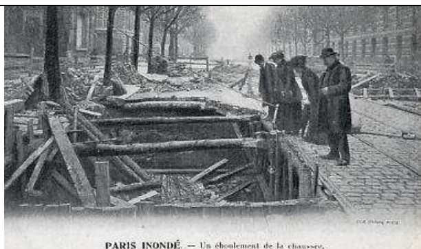
Effondrement de chaussée. Boulevard Saint-Germain
