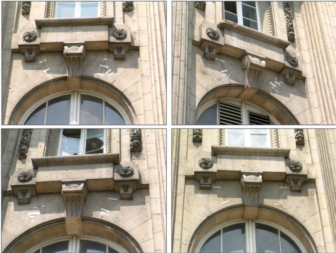
Figure 148 : Quelques exemples de déformations du Grand Palais en rive droite de la Seine. Les barres blanches correspondent aux témoins au plâtre des fissures affectant les fenêtres du Grand Palais.
