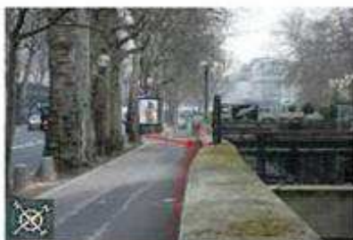
Photo 1 : Déformation muret côté rue
