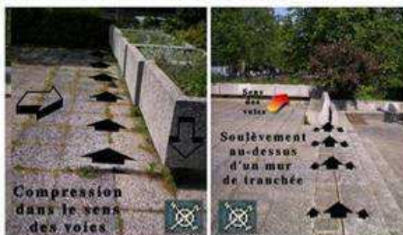
Photo 1,2 : Décalage des bacs, soulèvement des dalles
