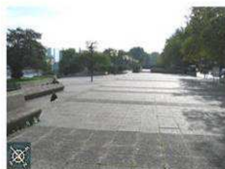
Photo 3 : Soulèvement de l'esplanade Tino Rossi au dessus du mur NE de la tranchée
