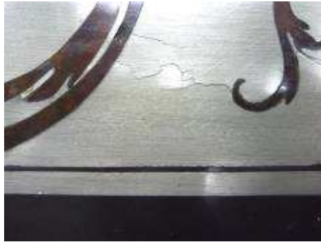
Figure 13 : détail d'un élément en étain fissuré ; noter le réseau plus clair, prémisse de fissuration
